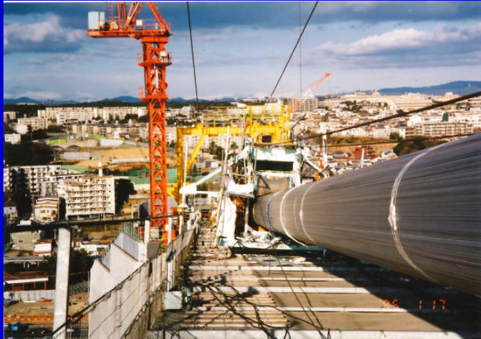
震災当日、キャットウォーク上から見た工事の中主ケーブルと垂水の町
